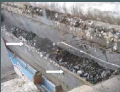
Figura 2. Canales de drenaje de aguas totalmente deterioradas por excremento de palomas.
